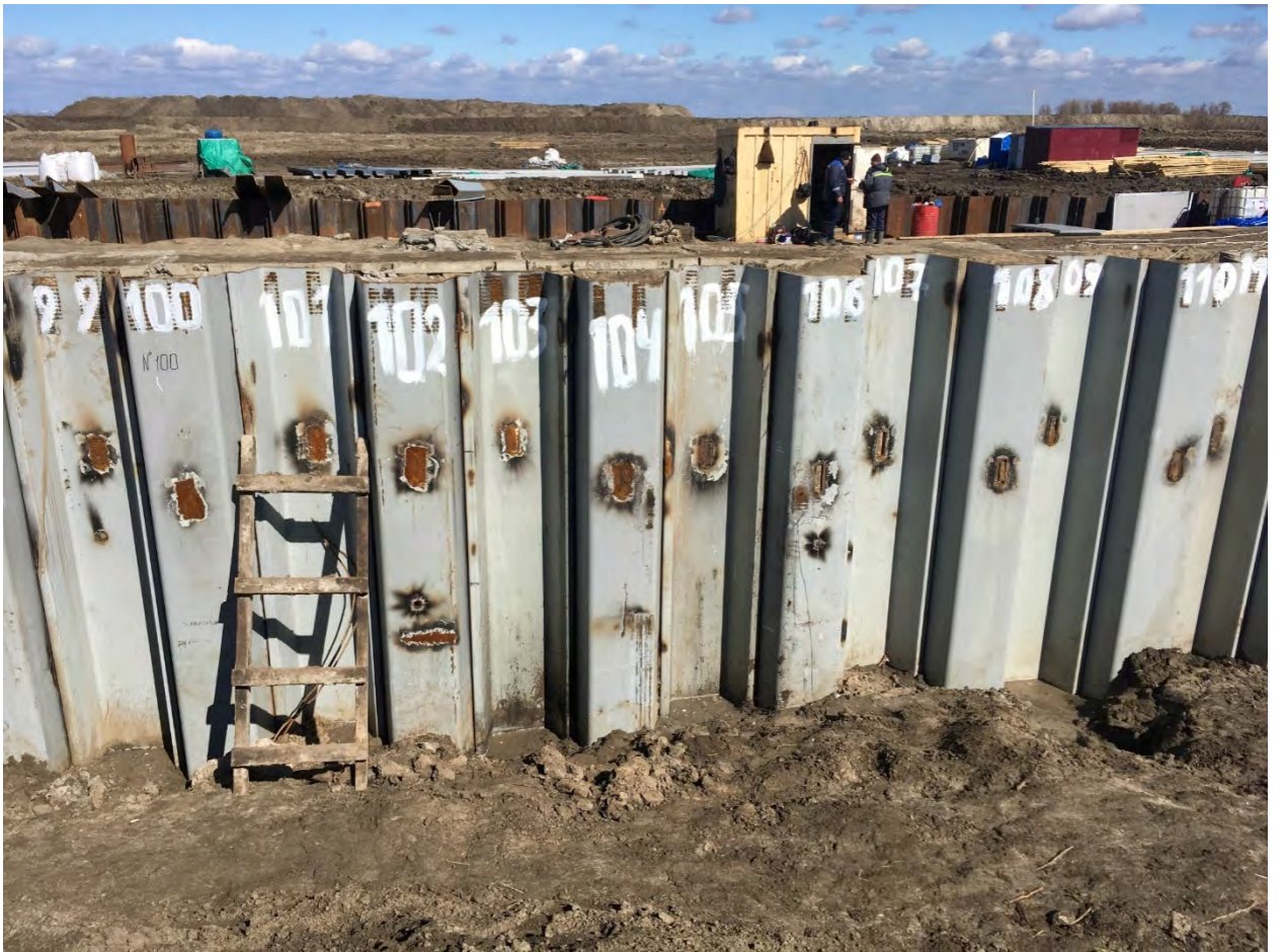
Дефект с расхождением замка выявлен и устранен.
