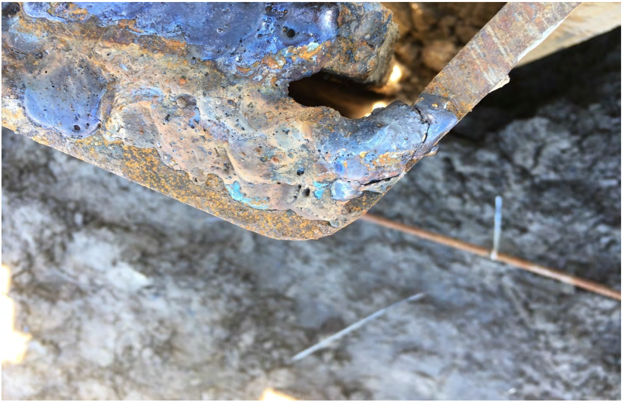
Выявление дефектов сварки м/к
