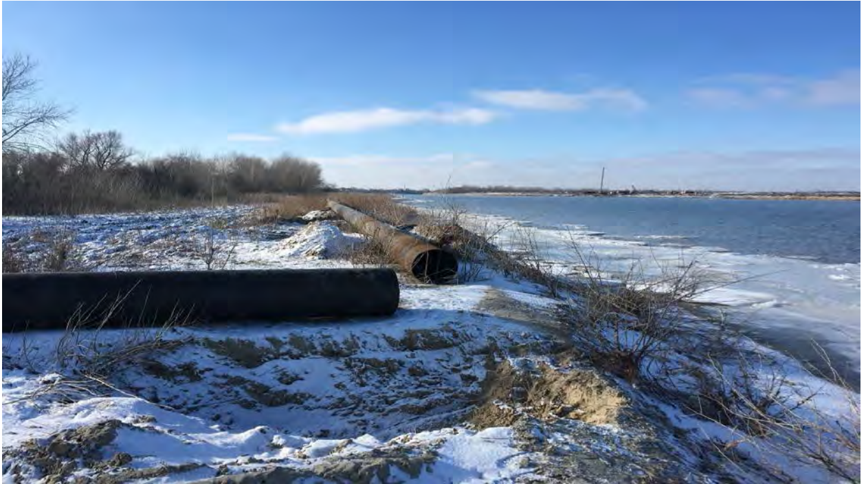
Большой остров. Пульпопровод ф630мм через остров и секция пульпопровода (вдоль берега) для стыковки и подачи пульпы через р. Дон.
