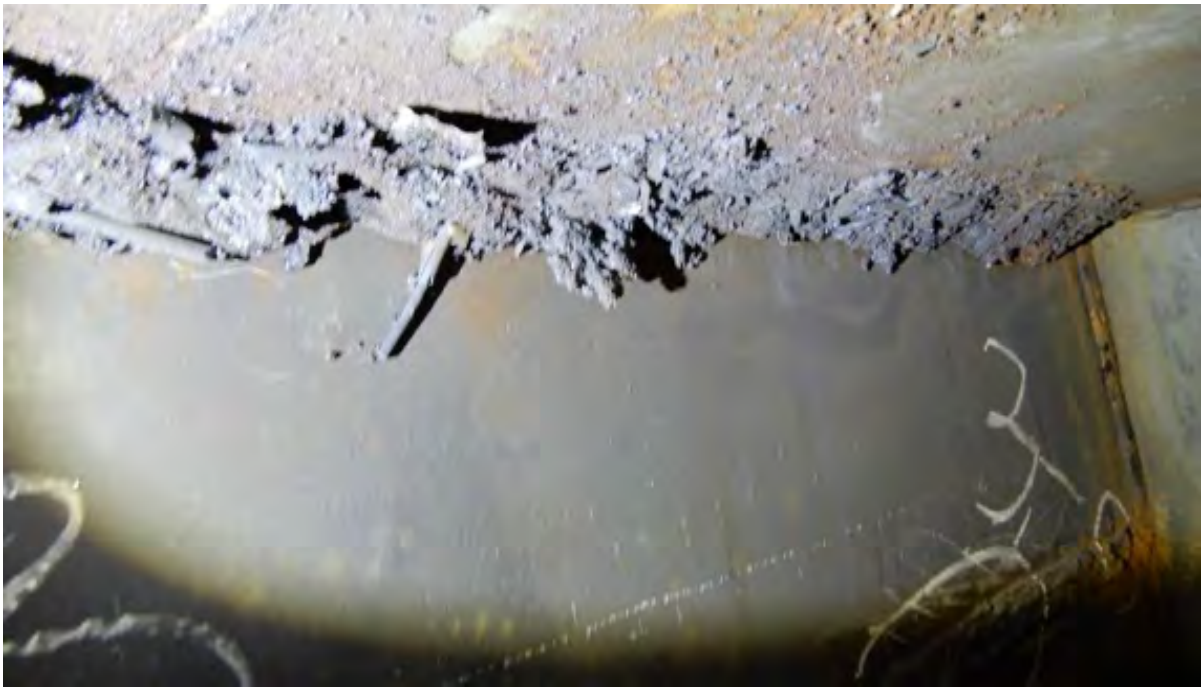
Шлак и брызги металла. Требуется слесарная обработка сварного шва и околошовной зоны.
