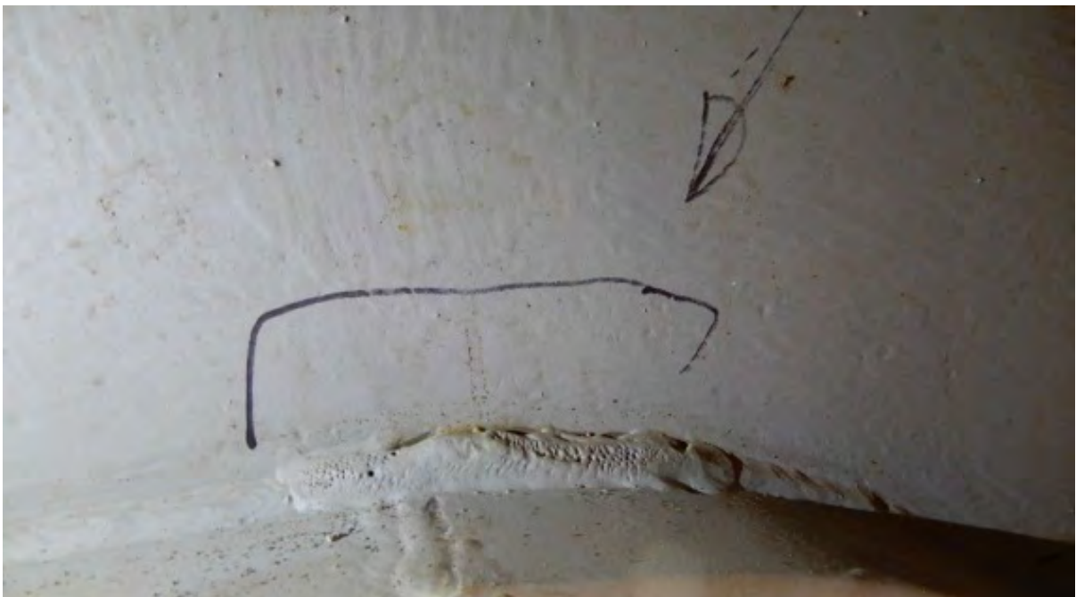
Цепочка пор. Требуется слесарная обработка по удалению пор и восстановление сварного шва.
