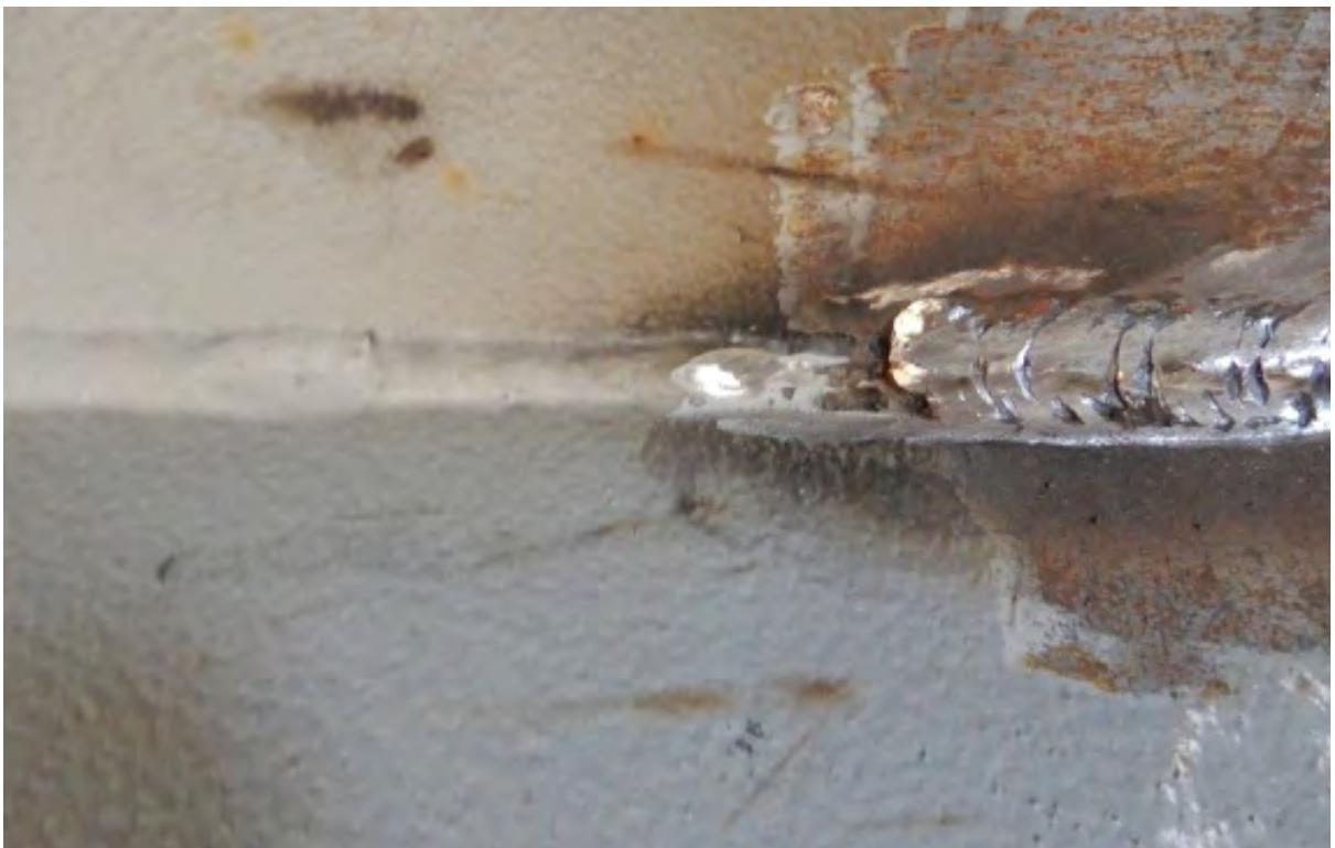
Незаваренный кратер. Требуется слесарная обработка и исправление сварного шва.
