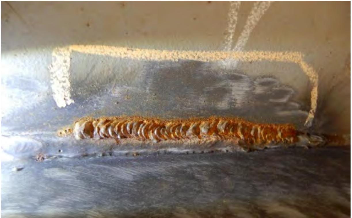
Превышение чешуйчатости и отклонение по геометрии шва. Требуется слесарная обработка и исправление сварного шва.
