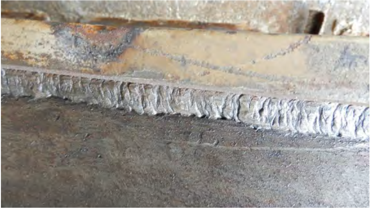
Подрез, чешуйчатость, неправильное формирование сварного шва. Требуется слесарная обработка и исправление сварного шва.
