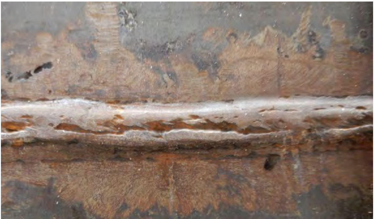
Свищ и подрез сварного шва. Требуется слесарная обработка по удалению свища, восстановление и исправление сварного шва.
