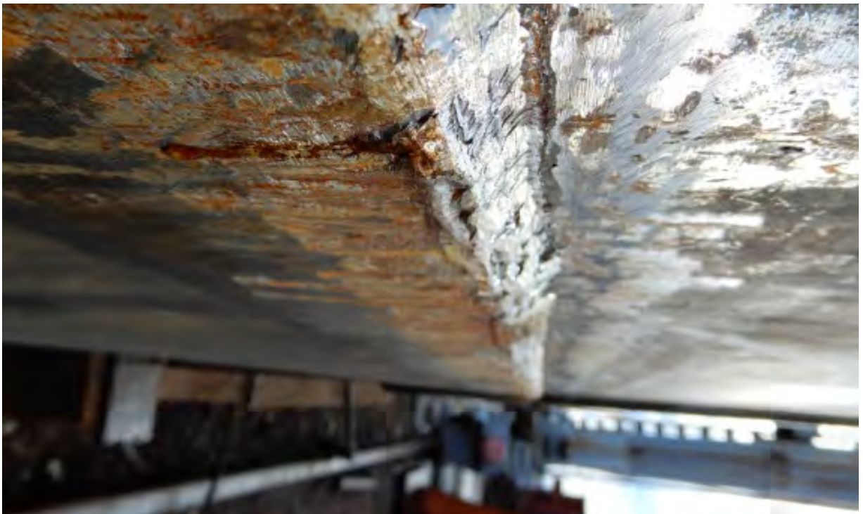
Превышение кромок сварного шва. Требуется слесарная обработка, выполнение кромок согласно ГОСТ 5264-80, исправление сварного шва.
