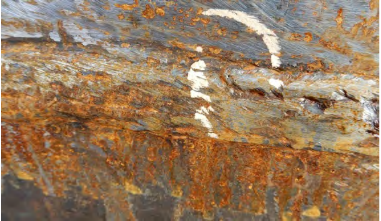
Межваликовые западания и поры в сварном шве. Требуется слесарная обработка, удаление пор и исправление сварного шва.
