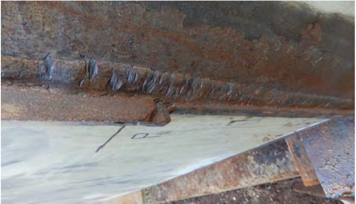
Превышение чешуйчатости шва. Требуется слесарная обработка сварного шва.
