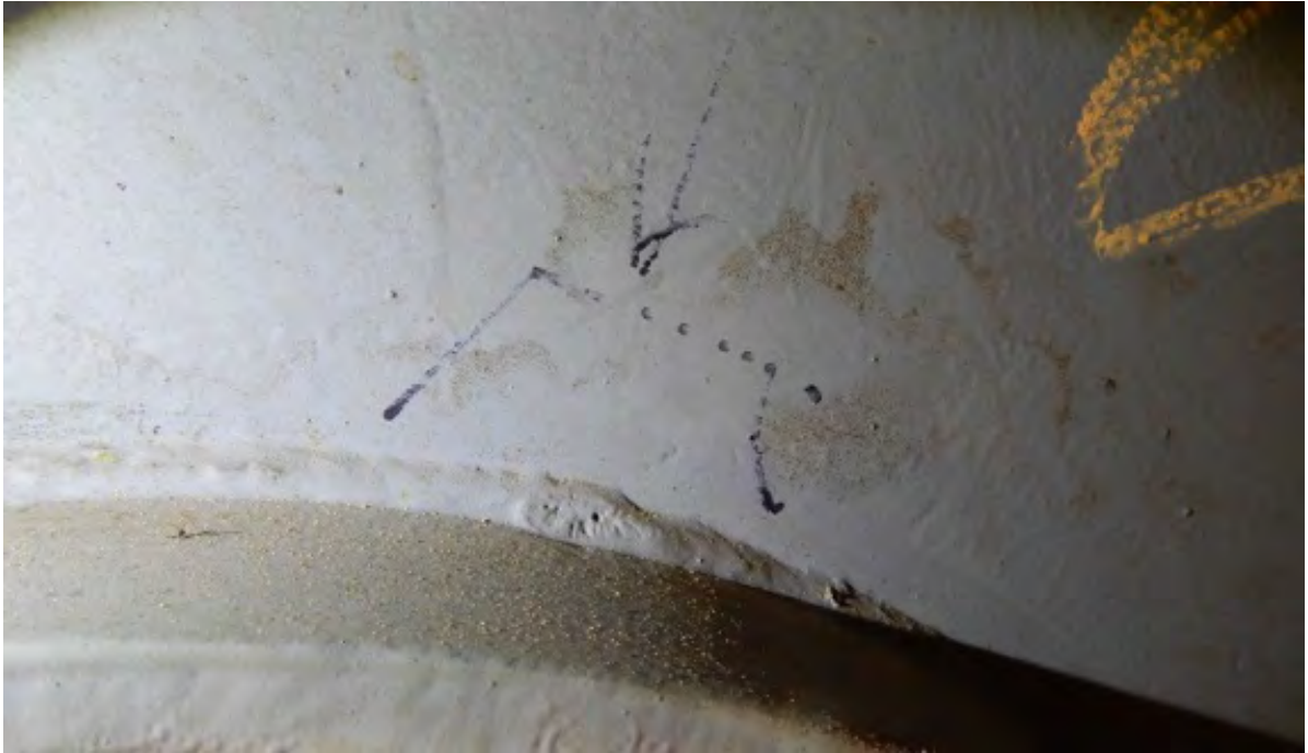
Скопление пор в кратере. Требуется слесарная обработка по удалению пор и восстановление сварного шва.
