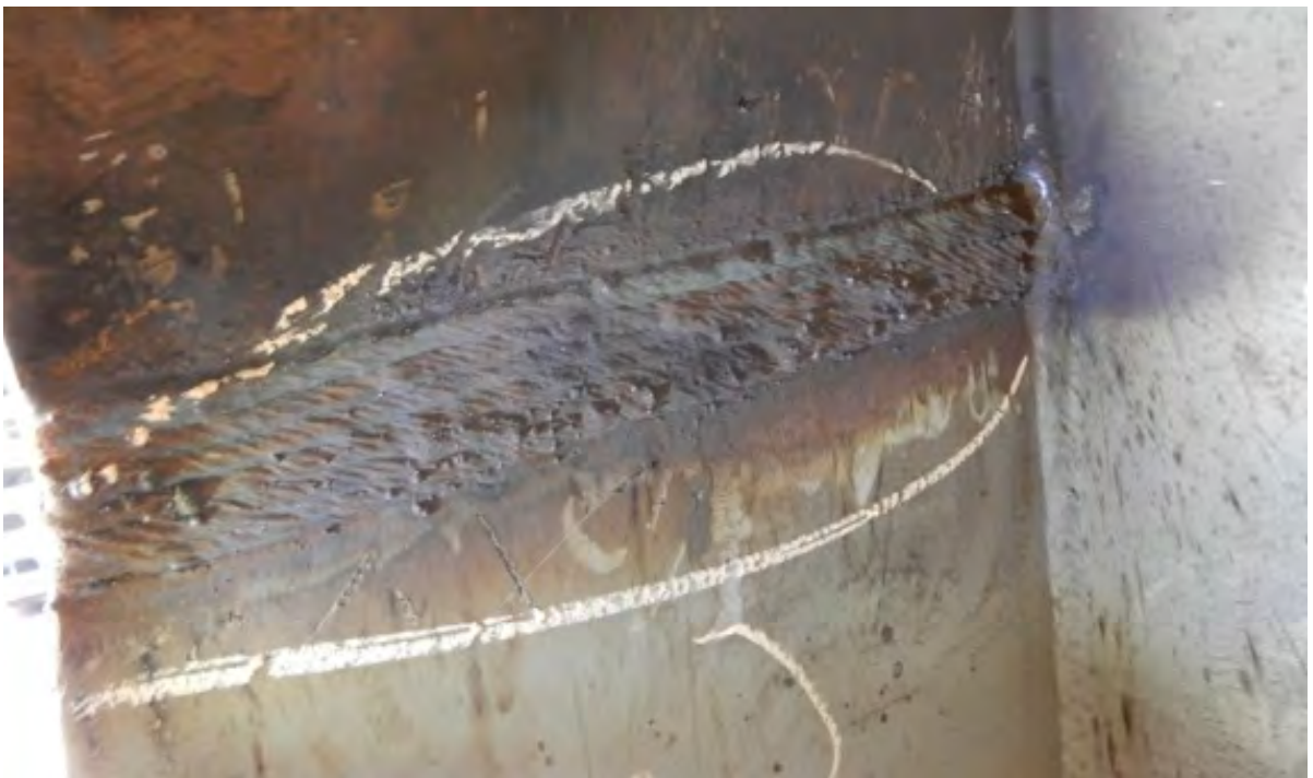
Неправильная геометрия сварного шва. Необходимо заменить свариваемые элементы, выполнить новый шов или согласовать указанный шов (размеры не соответствуют ГОСТ 5264-80) с проектной организацией.
