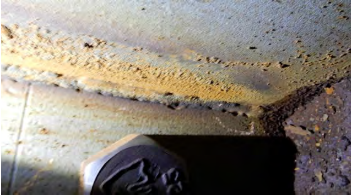
Поры и подрезы сварного шва. Требуется слесарная обработка по удалению пор, восстановление и исправление сварного шва.
