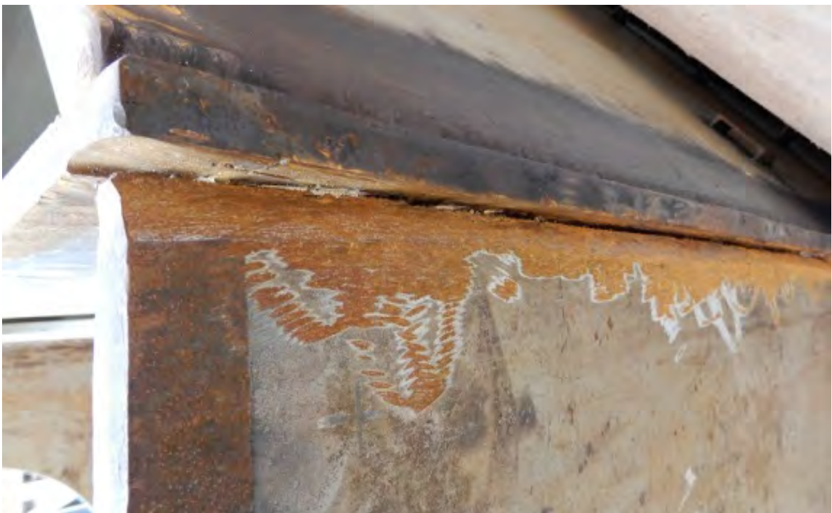
Превышение зазора между кромками сварного шва. Необходимо исправить зазор и выполнить слесарную обработку кромок.
