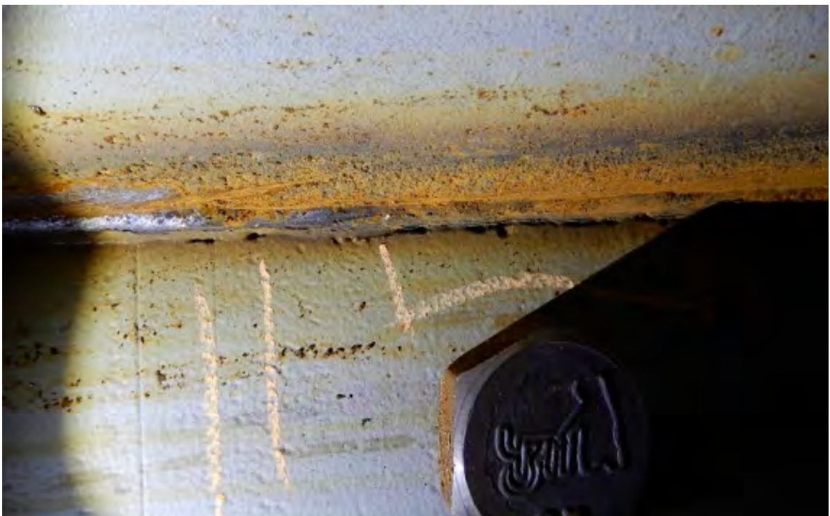
Поры и подрезы сварного шва. Требуется слесарная обработка по удалению пор, восстановление и исправление сварного шва.
