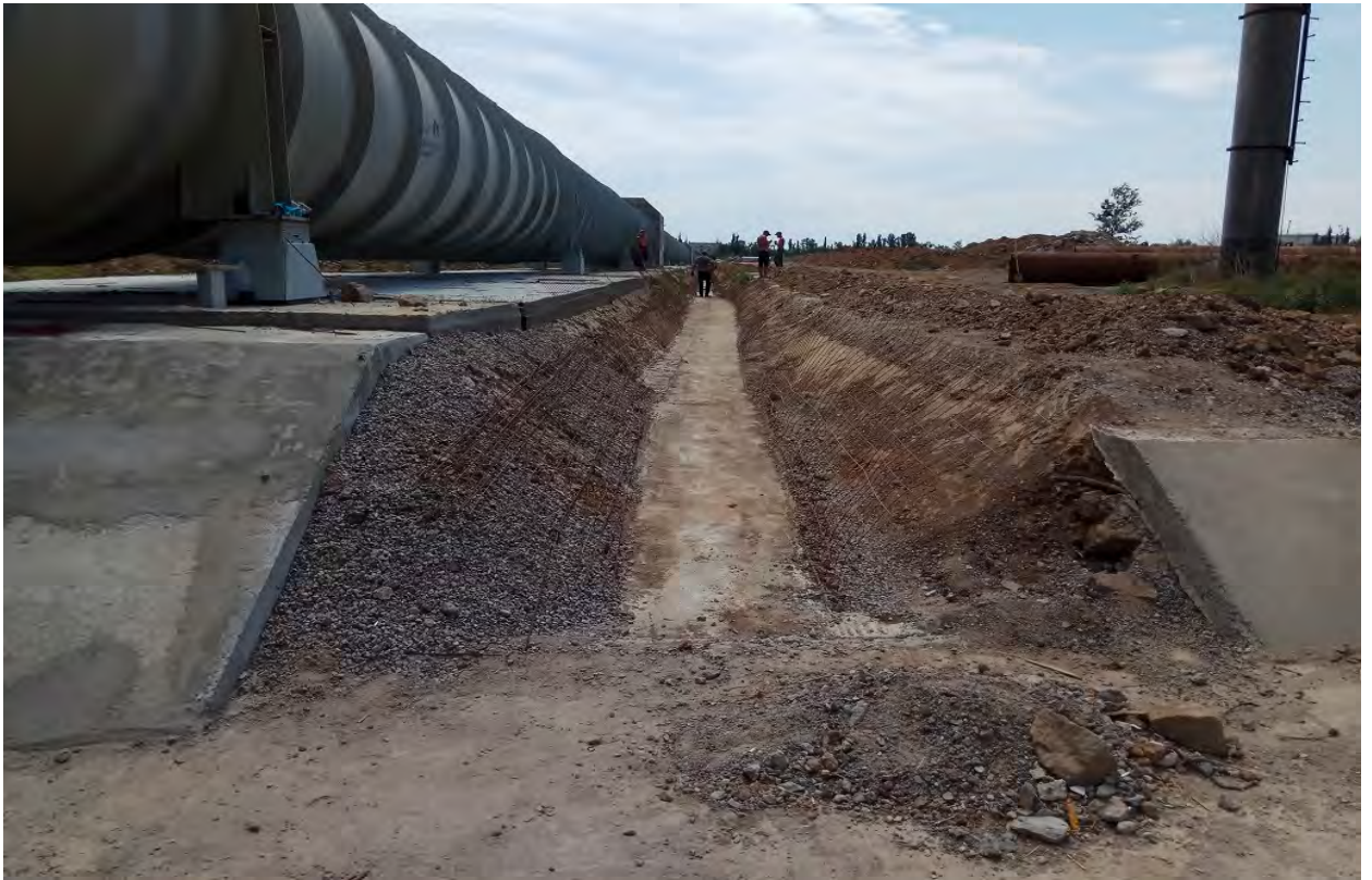
Фото 3. Выемка траншеи, профилирование дна и откосов, подготовка к бетонированию аварийного кювета нитки трубопровода №3
