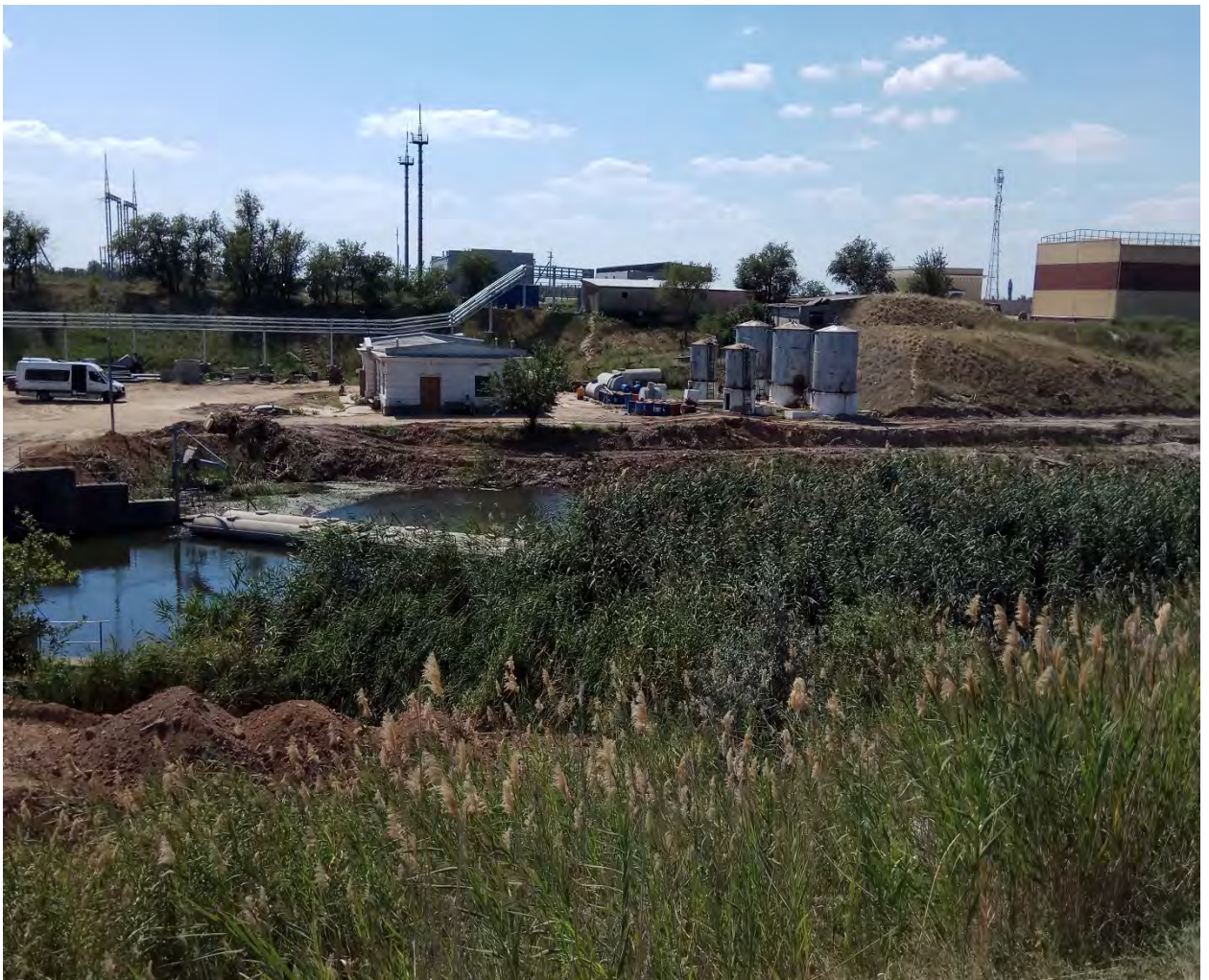
Фото 9,10. Разравнивание отвалов грунта на берме и бровке правого берега подводящего канала от автодорожного моста до аванкамеры насосной станции для проезда транспорта и техники.
