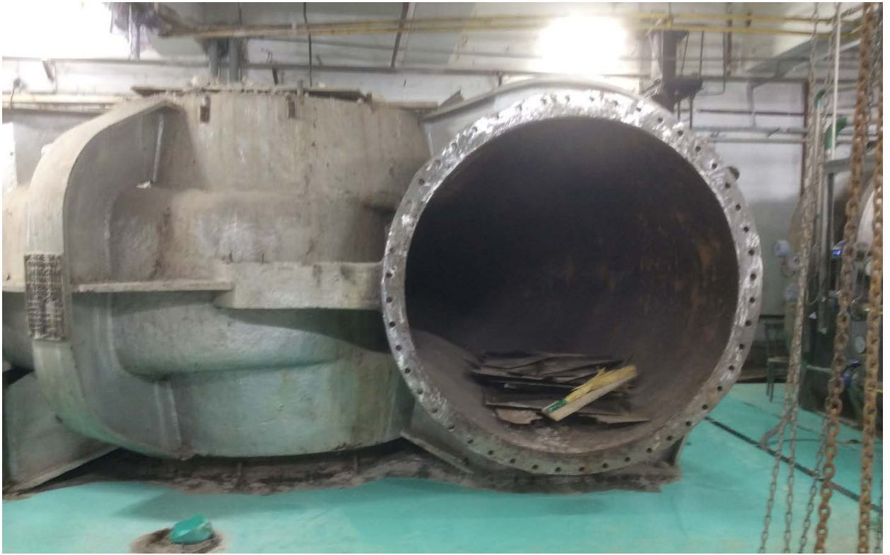
Фото 5. Фланец улитки насосного агрегата № 3 для соединения с промежуточной частью напорного трубопровода
