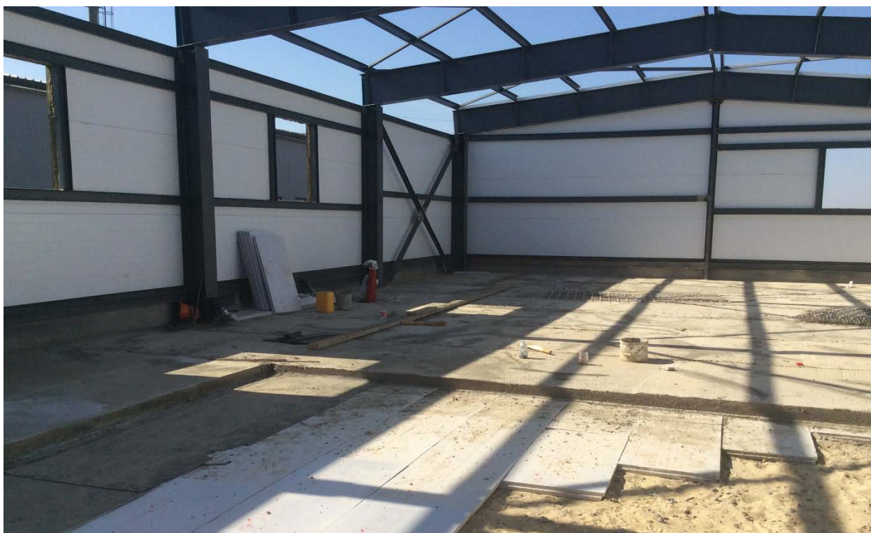
Фото 1,2. Укладка на песчаную подготовку утеплителя из плит Пенополистирола, гидроизоляции и бетонирование пола здания энергодиспетчерского пункта
