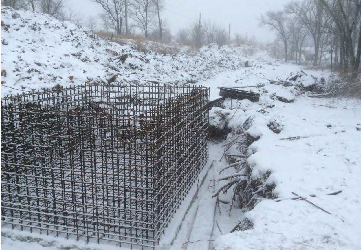
Фото 23. Устройство на конечном участке сифонного водосброса цоколя здания № 2 для управления сбросом воды
