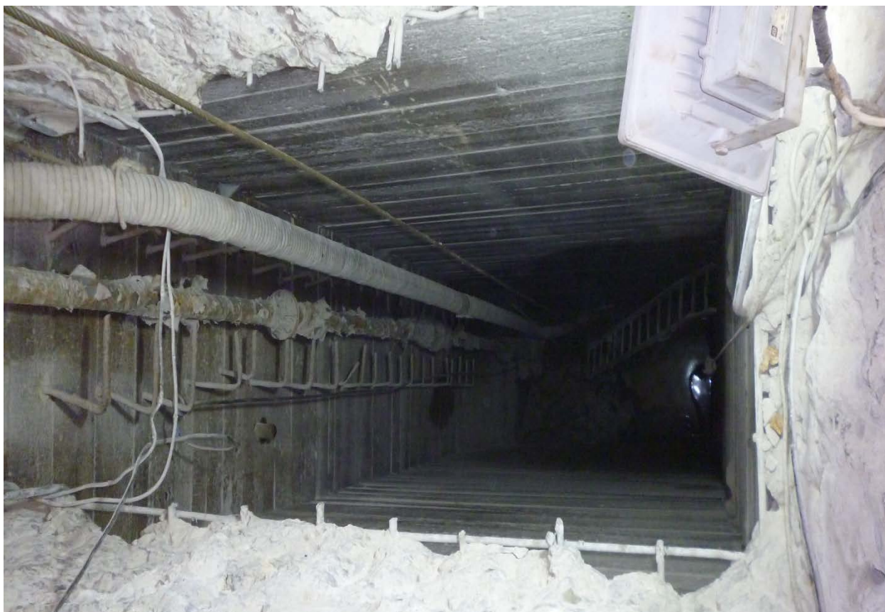
Фото 1,2. Вырубка проемов в шахтные колодцы, удаление старой арматуры и очистка колодцев от колотой массы бетона
