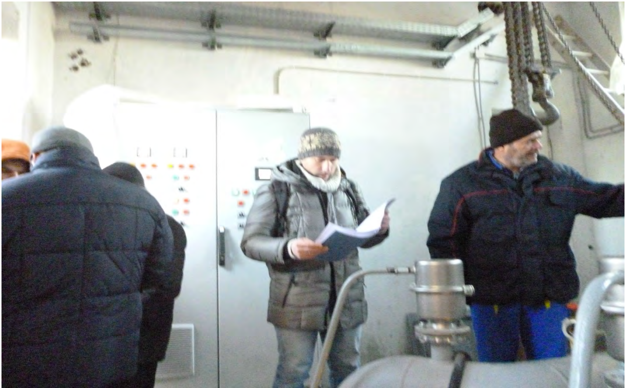
Фото 12-15. Монтаж основного и вспомогательного оборудования в шахтных колодцах и помещении управления насосами. Приемка работ.
