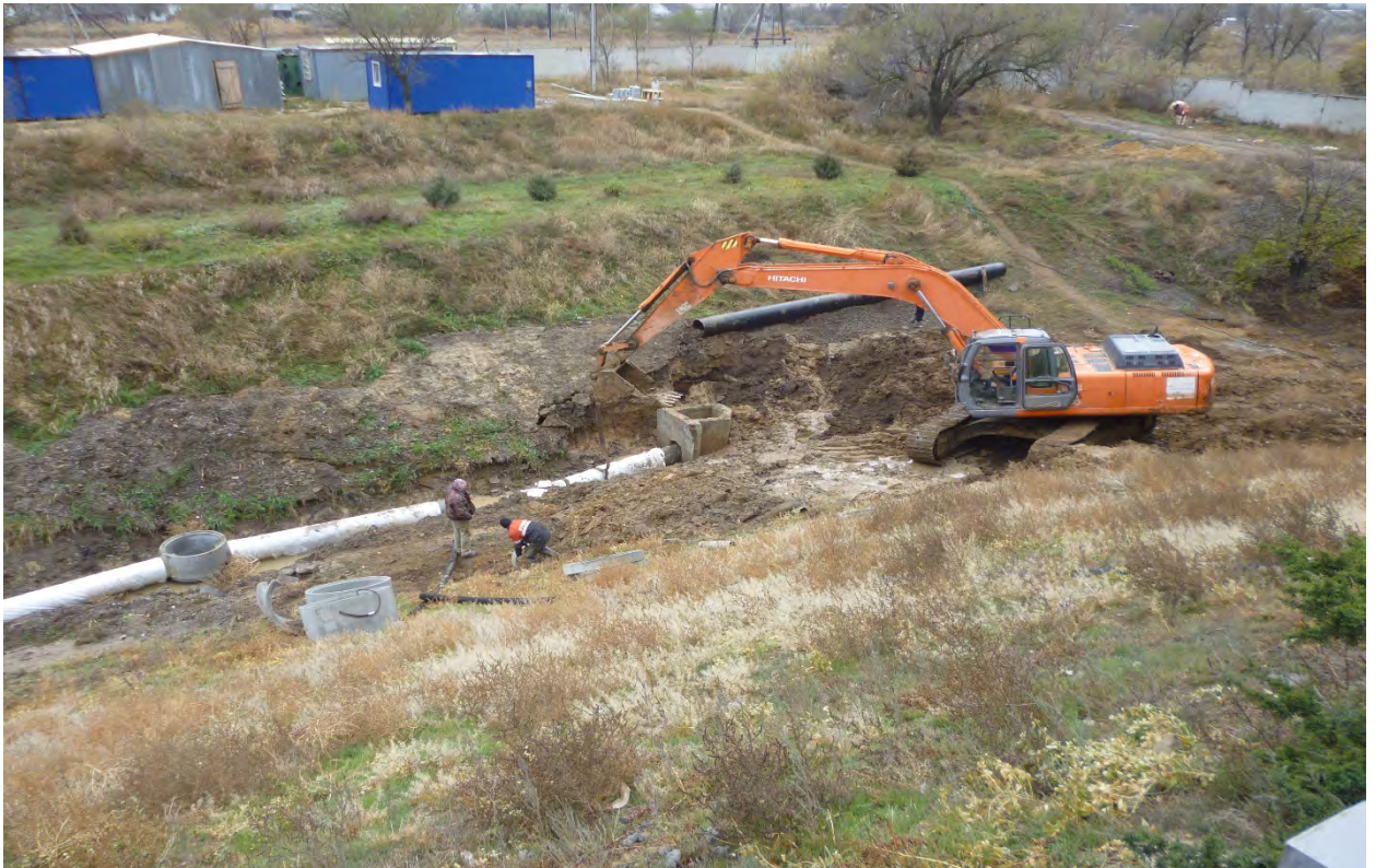
Фото 8,9. Устройство коллектора и подключение его к измерительному колодцу закрытого дренаж на правой стороне шлюза
